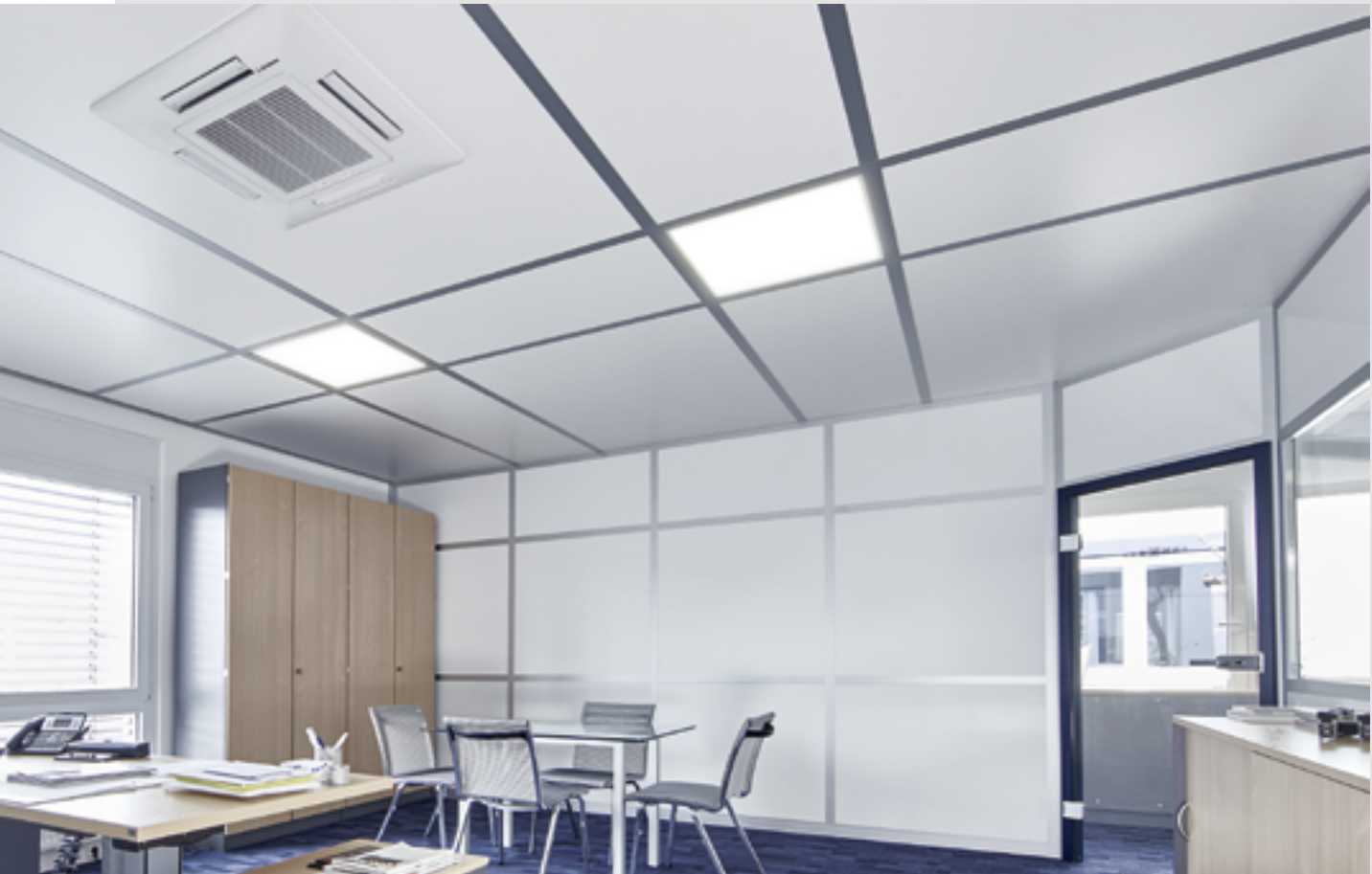
Bürodecke mit LED Leuchten und Klimagerät Office ceiling with LED lights and air conditioner
